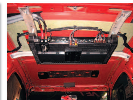
Voilà le câblage terminé.
